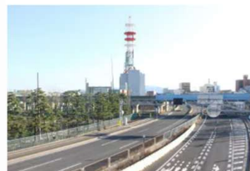
青森県で震度6強を観測した地震で損傷が確認されたNTT青森八戸ビルの鉄塔。手前は一部通行止めとなった国道45号＝20日午後、青森県八戸市
